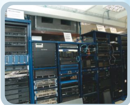
Помещения компьютерных залов и электронных узлов связи, серверные
