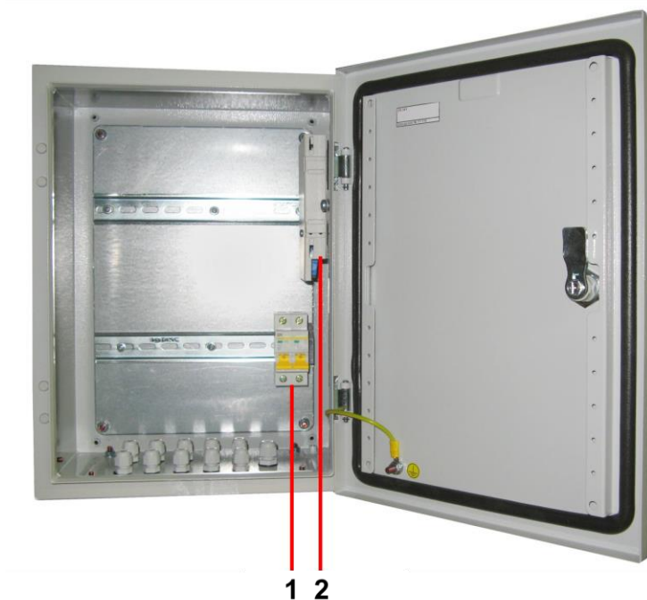
Рис.23 Уличная станция OS-341, внутренние элементы
